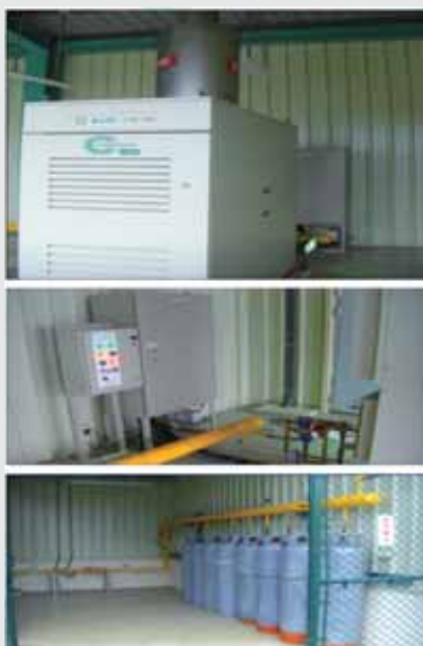
▲65 kW微氣渦輪機之建置
