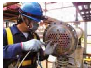
核二廠渦電流管路檢測
