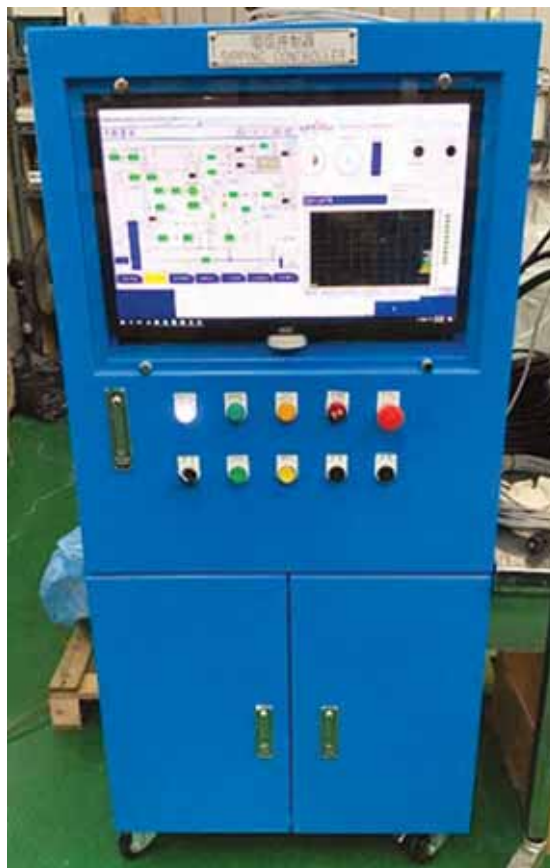
圖4. 燃料真空啜吸檢驗主控制箱
