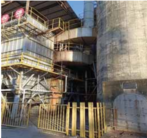
圖3. 場域測試位置：台糖善化廠鍋爐煙道氣出口
