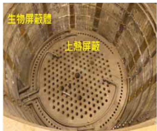
圖3. TRR爐體上熱屏蔽穿越管
