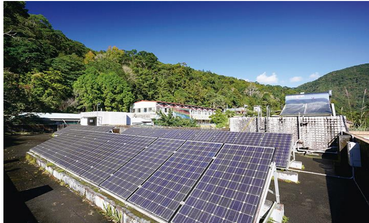
圖 6、烏來福山國小防災型微電網系統 資料來源：台灣電力公司(2018)
