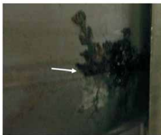
銲道周邊大面積洩漏痕跡
