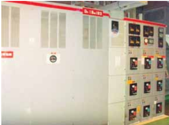
輔機廠房內緊要安全電氣盤面
