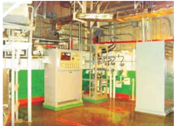
輔機廠房內事故後氫氣濃度偵測儀器
