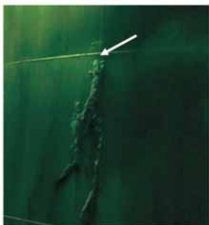
銲道周邊洩漏出之液體已有大面積結晶現象
