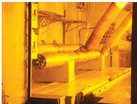
熱室安裝完成之特殊設計貯存罐
