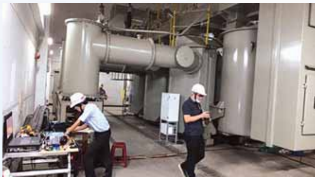
在線診斷之電力變壓器
