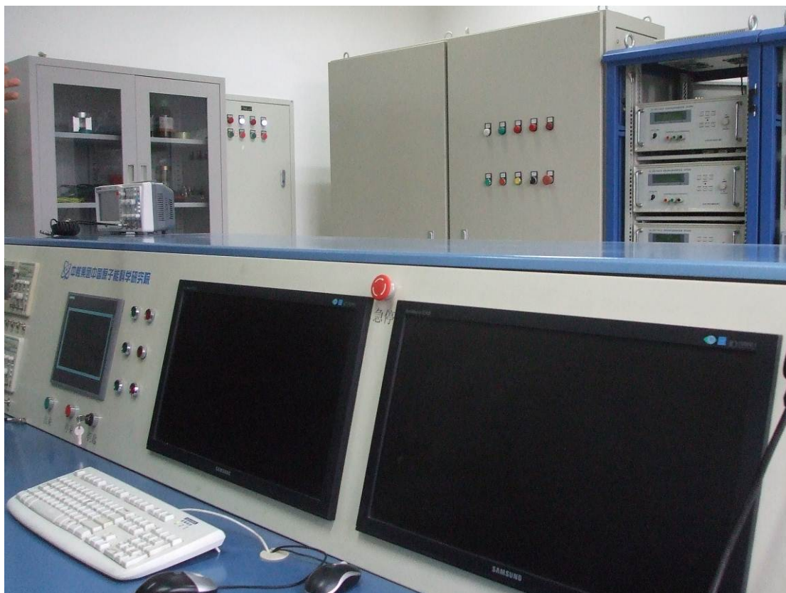
圖 15 直線加速器之控制室
