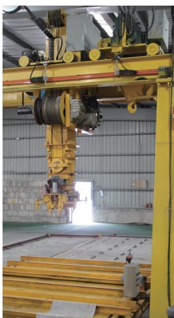
▲ 高活度乏燃料套管抓取設備
