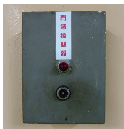
▲ 安全連鎖裝置(門一開，射源馬上降入水池)
