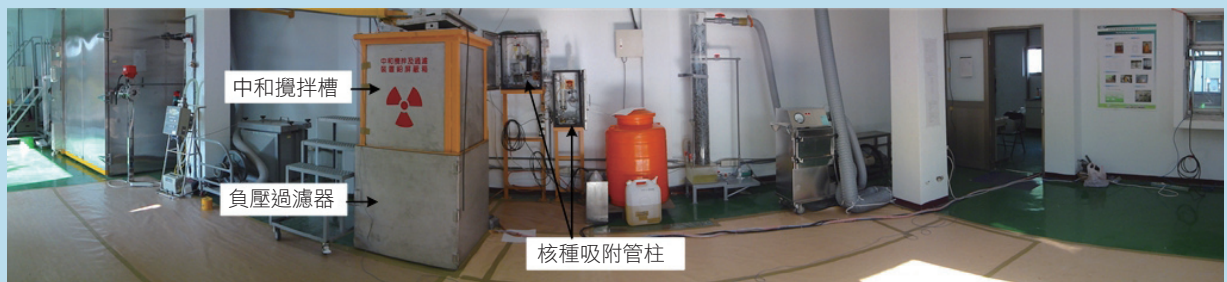
▲ 酸性廢液之處理設備全景
