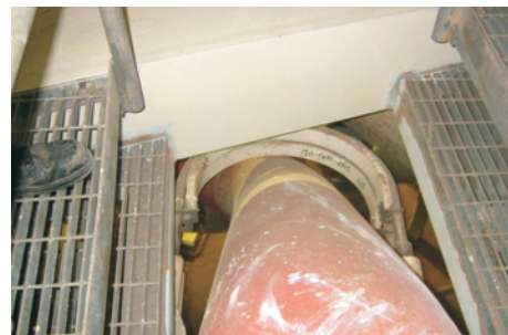
(c) 管路揮動限制器之安裝角度不符合要求
