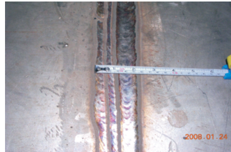
(a) 抑壓池不銹鋼板銲道根部間隙過大
