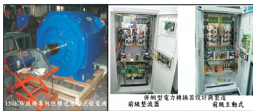
▲ 與廠商協力開發150kW發電機與電力轉換器
