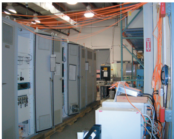
▲龍門電廠安全數位儀控系統整合測試
