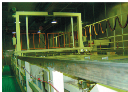
▲化學及電化學除污設備實景
