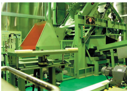
▲機械除污設備實景
