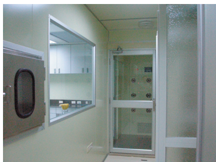
▲潔淨室等級之隔離更衣室
