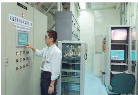
▲高減容固化系統之PLC主控制盤及電腦
