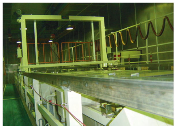
▲化學及電化學除污設備實景
