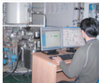
▲圖2 本所 1kW SOFC 發電驗證系統實體照片
