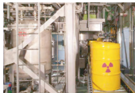
▲固化漿體承裝與廢棄物桶輸送設備
