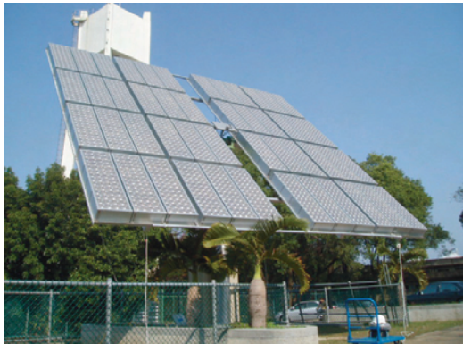
▲5kWp聚光型太陽光發電示範系統
