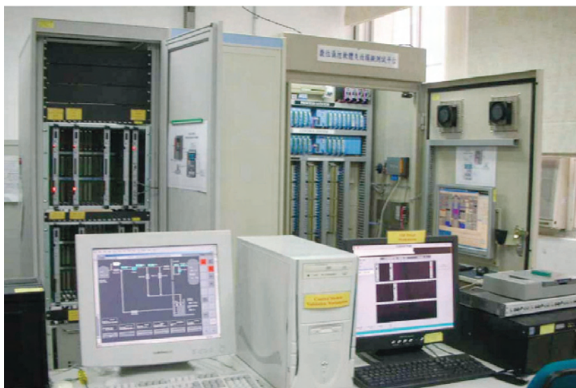
▲數位儀控軟體失效模擬測試平台
