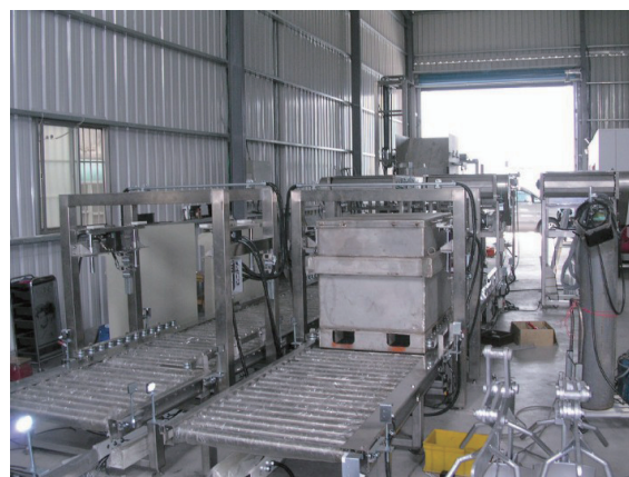
▲廢棄除污劑固化處理設備
