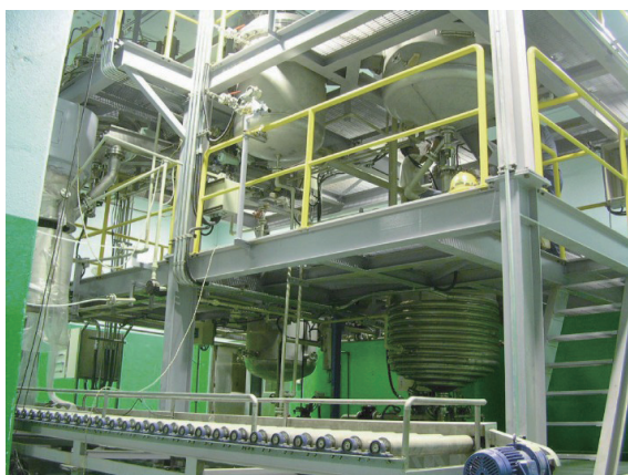
▲前置分類處理設備
