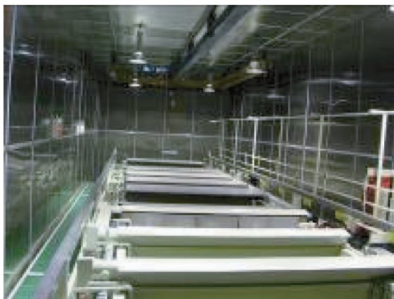
▲污染隔離罩內化學及電化學除污設備
