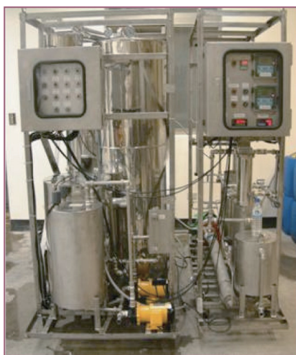
▲本所回收廢水處理示範系統
