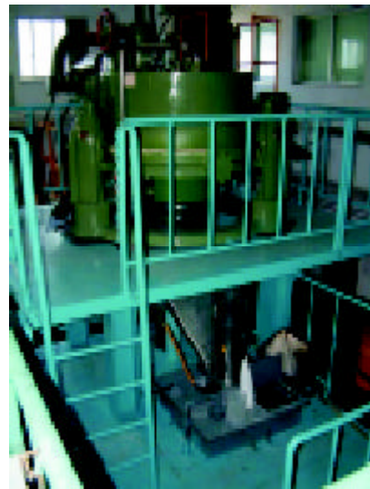
■建構在036X館反應物飛灰水洗處理設備
