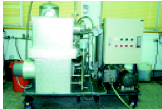
■半導體有機廢水處理測試裝置
