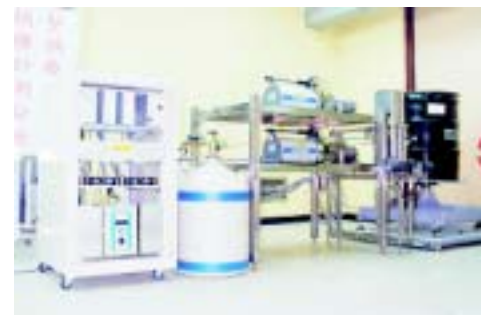
■ 低放射性水泥固廢料整桶計測儀器設備
