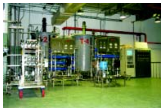
■ 先導型洗浴廢液薄膜處理設施
