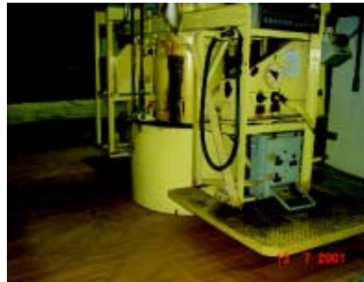
■ 屏蔽鐵圈及操作台
