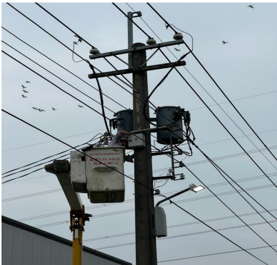
圖 5、DCU 現場佈建(台南架空 饋線)
